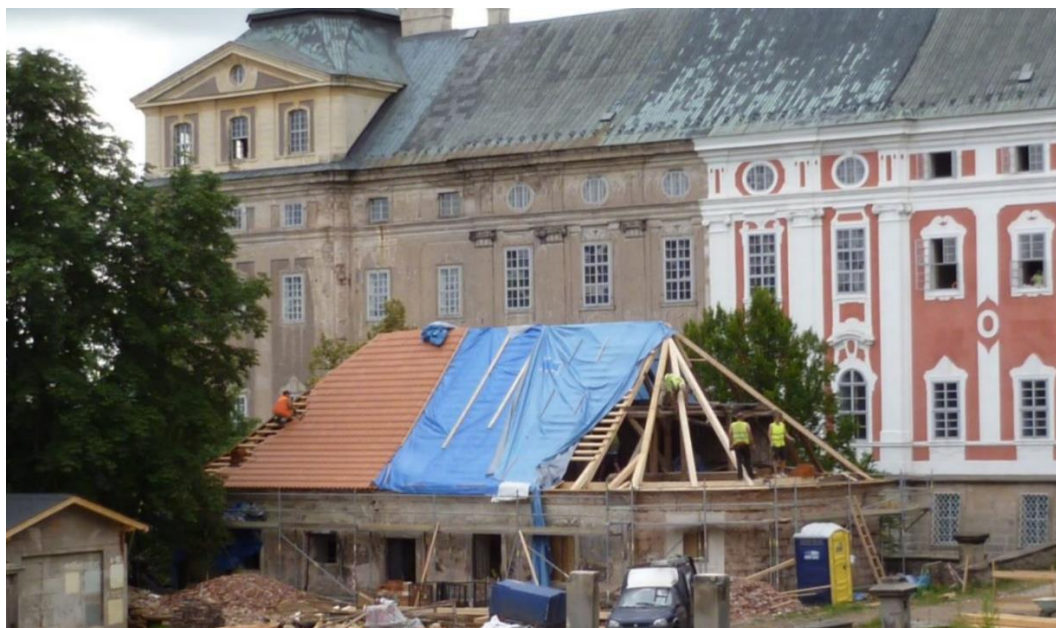
Obrázek 6 Průběh revitalizace broumovského kláštera, rekonstrukce kuchařova domu a postupující oprava severní fasády
